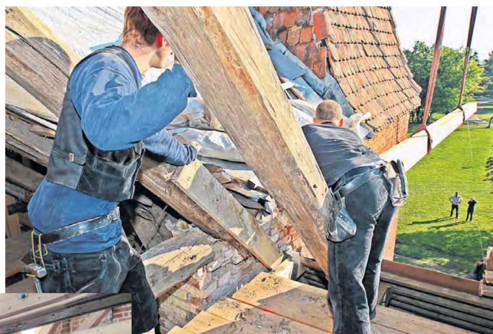
• Rechts Eine Menge Holz: Bis zu neun Meter lange Balken sind per Kran „eingeflogen“ worden, um das Dach wieder auf eine stabile Unterlage zu stellen.
